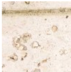
... en in detail de dooizoutschade
