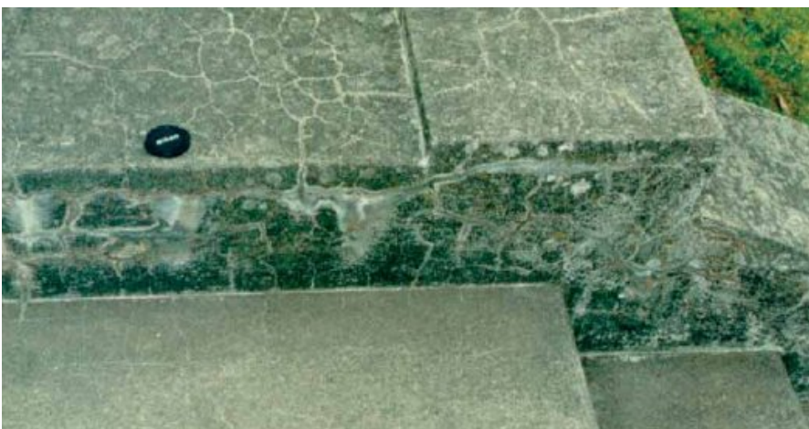
Typisch voorbeeld van ASR-schade
